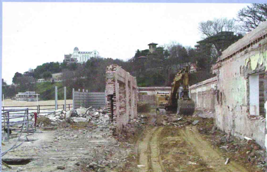
El balneario de la playa de la Magdalena fue derribado tras detectarse problemas en su estructura.
