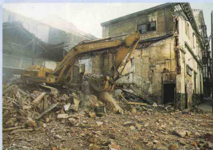
El desplome del tejado del cine Bonifaz obligó a su derribo.
